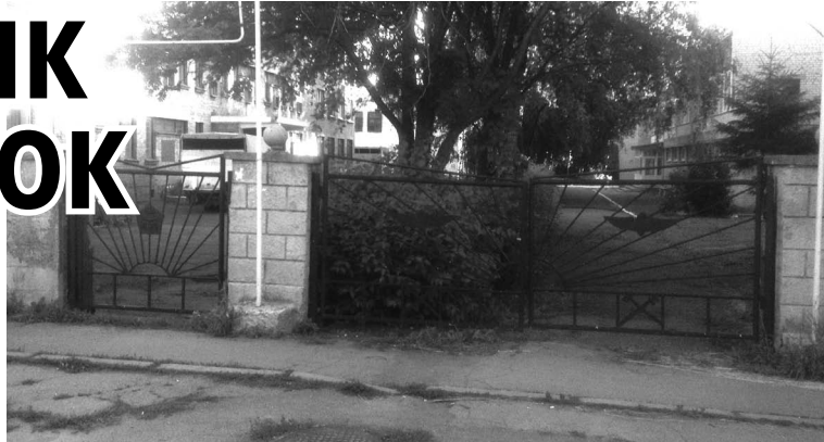
Заварена хвїртка на центральному вході
