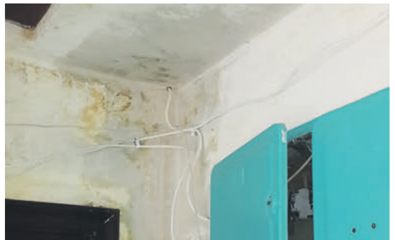
Вода з даху стікала аж на перший поверх. Але сусіди, що постраждали від затоплень, не захотіли судитися
