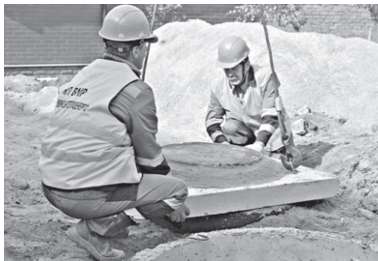
Тепловики оцінять мережі, якими раніше опікувався «Маяк». Відповідно до аналізу почнуть їх ремонт, якщо в цьому буде потреба
