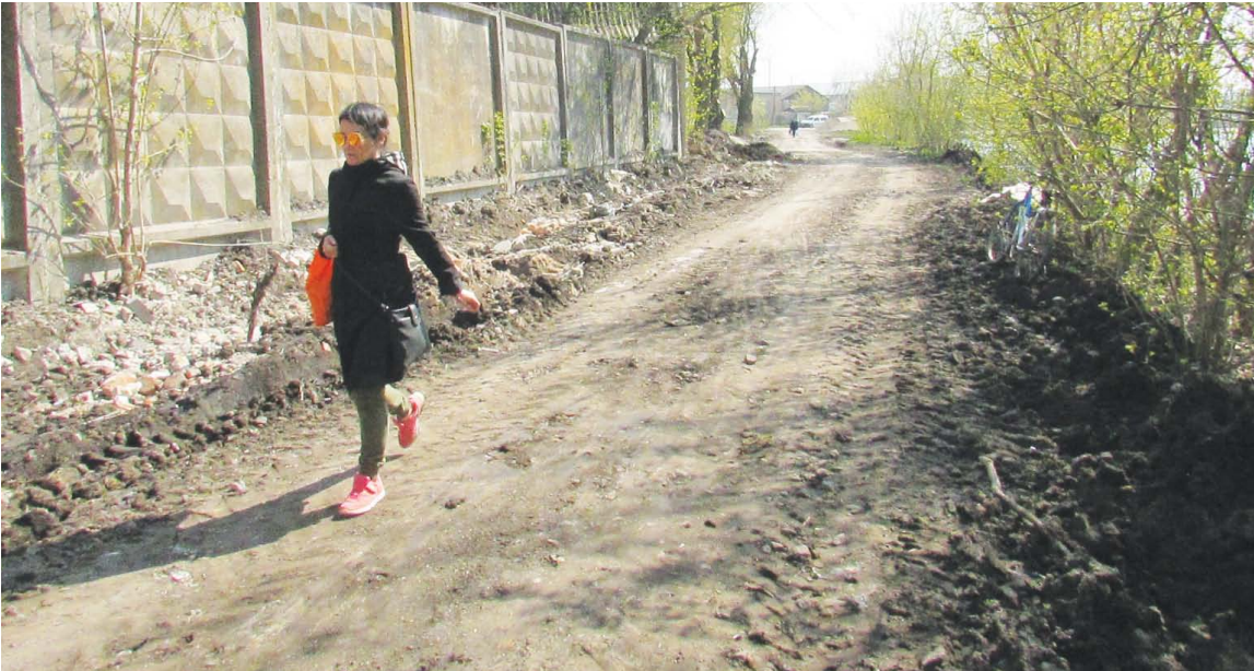
Ще тиждень тому тут була хороша дорога. Робітники поскидали землю з канами
