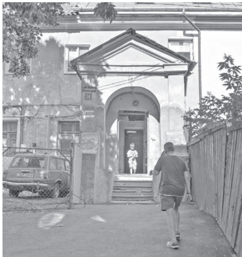
Фасад дому облущений і весь у тріщинах.
