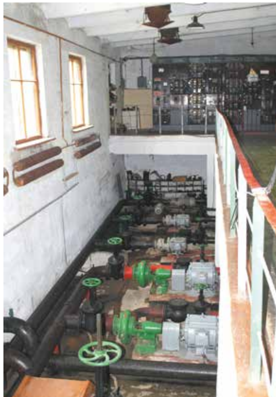
➔ Машинна зала другого підйому
