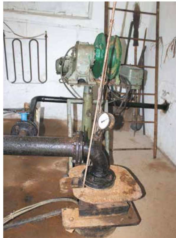
➔ Насосна станція, де встановлено новий насос
