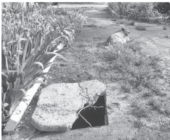
Через цей люк каналізації мешканці вулиці О. Кошового не можуть на вулицю відпустити дітей
