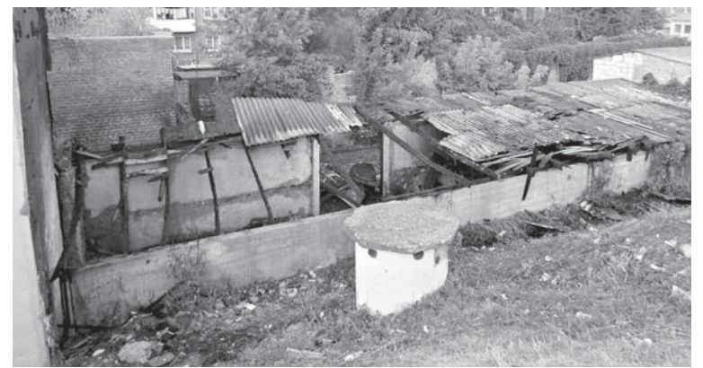
Від складського приміщення майже нічого не залишилося
