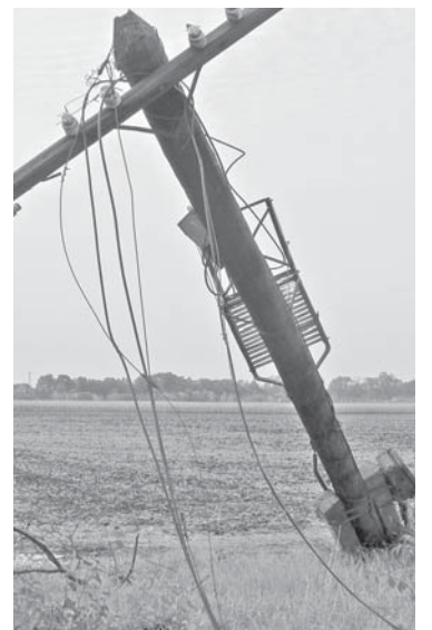
Небезпека поряд. Опора на об'їзній трасі
