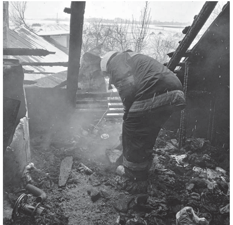
Вогонь знищив дах у будинку Олександра Шевченка. Через це впала стеля, затопило підлогу, постраждало опалення
