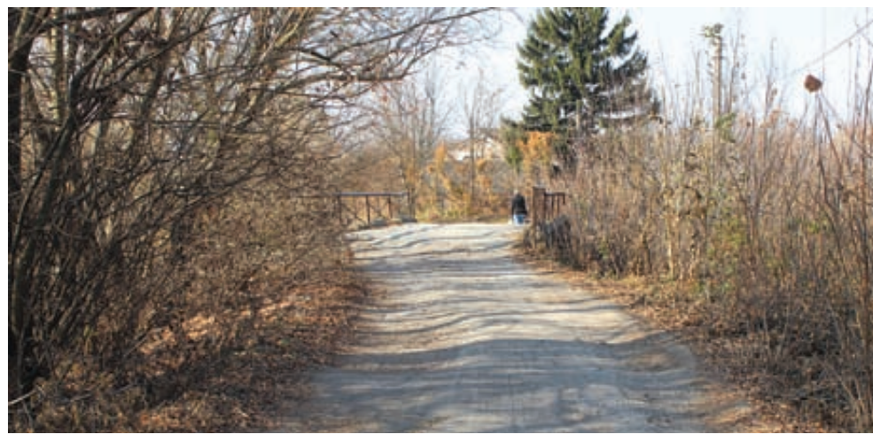
Місток через Водокачку вже давно потребує ремонту
