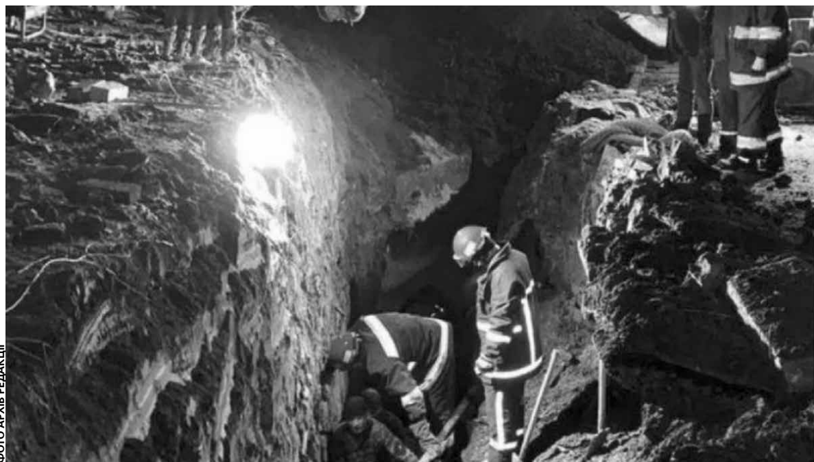
Близько опівночі виконроб поїхав з місця, а бригада залишилась працювати. Невдовзі посунувся ґрунт і землею засипало двох людей
