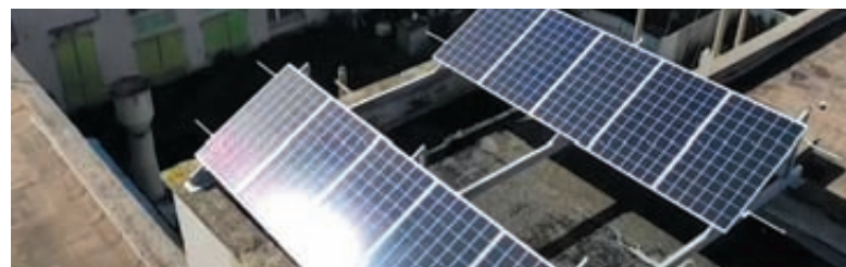
Сонячні панелі на даху ВНТУ. Електроенергії, яку вони виробляють, вистачає лише для часткового заміщення традиційного споживання
