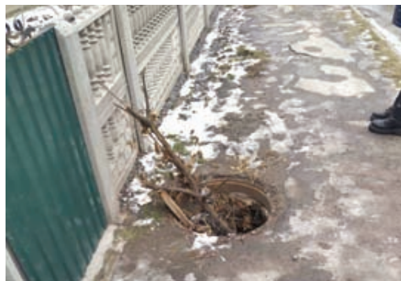
Небезпечні відкриті каналізаційні люки. Замість металевих кришок прикриті гілками з дерев
