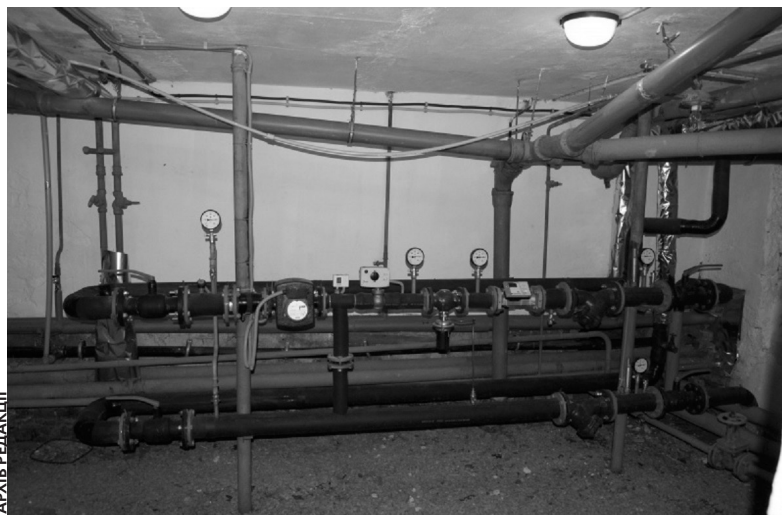
До жовтня 2023 року у Тернополі планується оснастити всі житлові будинки вузлами комерційного обліку в складі ІТП
