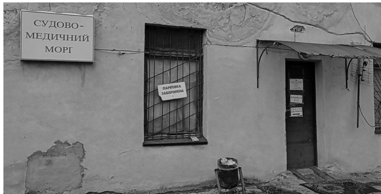
Приміщення моргу зовні давно потребує ремонту
