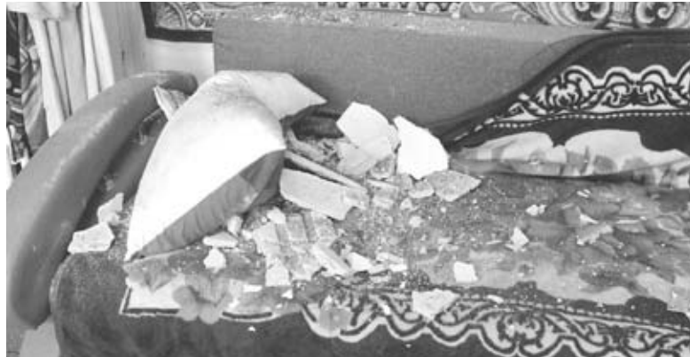
Шматки штукатурки зі стелі впали на постіль
