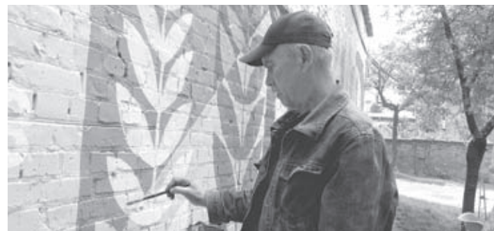
ПІДСТАНЦІЮ ПЕРЕТВОРЮЄ НА АРТ-ОБ'ЄКТ
