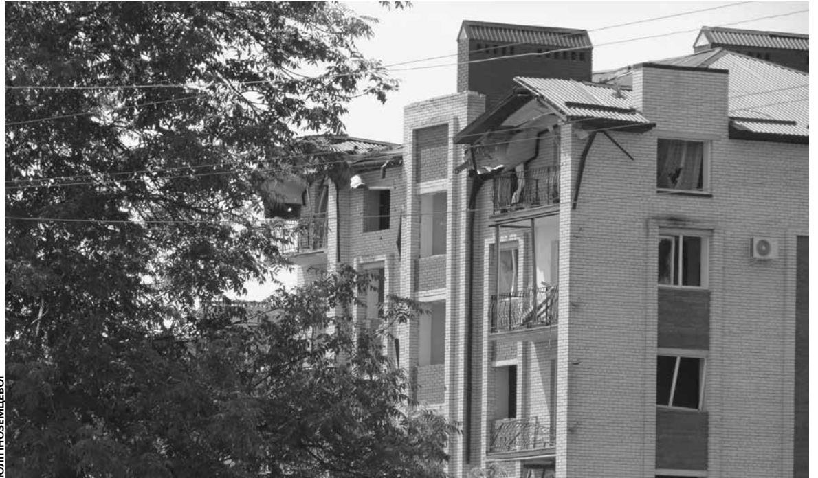
Внаслідок ракетного удару зруйновані житлові будинки, зазнали руйнувань школа, дитсадок, спортшкола, спалені машини
