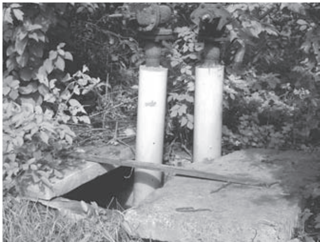
Відкритий люк біля ЦБТ на вул. Грушевського
