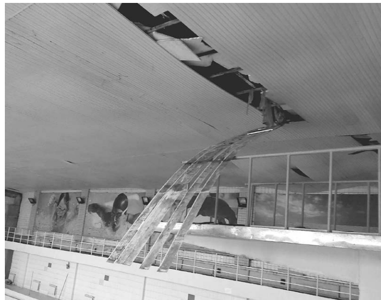
Нині приміщення басейну в аварійному стані. У деяких місцях вже почала падати стеля
