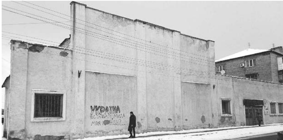
Районний будинок культури має такий вигляд, наче зовсім скоро трісне по швах. Приміщення визнали аварійним п'ять років тому
