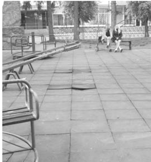
За цю плитку зачіплюються діти
