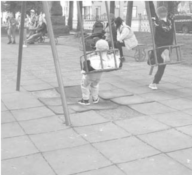
Настил біля центральної гойдалки потребує ремонту
