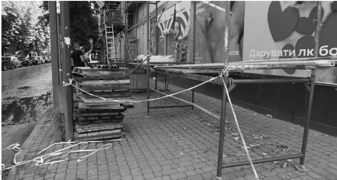
Частина тротуару перекрита через ремонтні роботи
