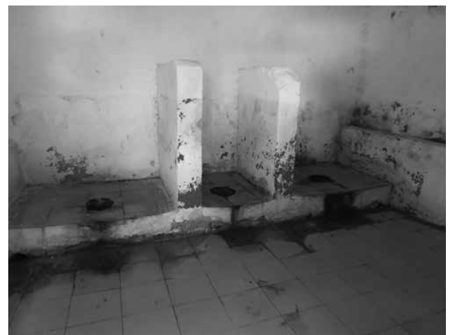
Туалет на «Дальньому» потребує ремонту
