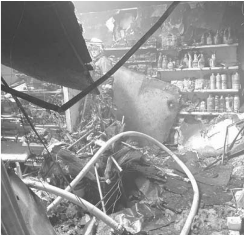
Зовні магазин не пошкоджений, а от із середини вигорів майже вщент. На фото обгорілі стелажі, в деяких місцях попадали конструкції зі стелі
