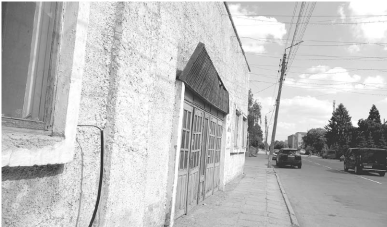
Будівля колишнього районного будинку культури. Від фасаду відкололася частина дерев'яної конструкції
