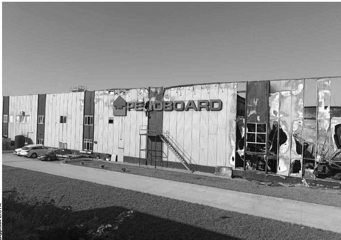
Площа горіння — 9 тисяч м. кв. Загальна площа будівлі 13 000 м кв., зі стінами з сендвіч-панелей та металевим покриттям на металевих фермах. Будівля була заповнена пінопластом
