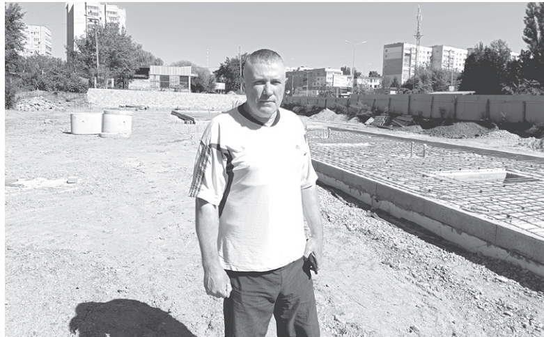
Віктор Вітенко каже, що усі стоки з автомийки потраплятимуть до них у криниці. За його словами, каналізаційні баки для комплексу закопали у ґрунт без будь-якої ізоляції
