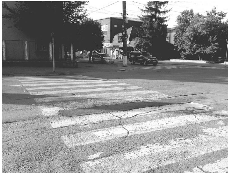
Зазвичай розмітку оновлюють після ямкового ремонту. А цього року було навпаки
