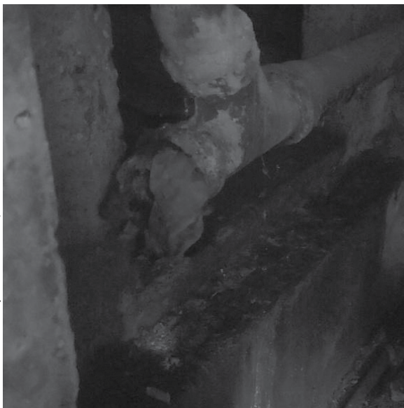
Люди хочуть облаштувати укриття у себе в підвалі, але там течуть старі труби
