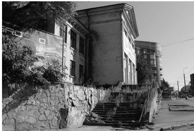
Сходи будівлі сипляться та заросли високими бур'янами
