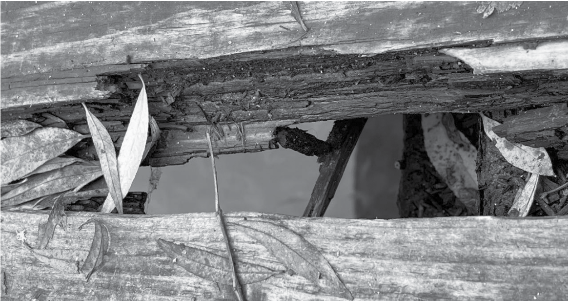
Дірки утворилися лише на перекритті. Основа конструкції металева і не потребує оновлення
