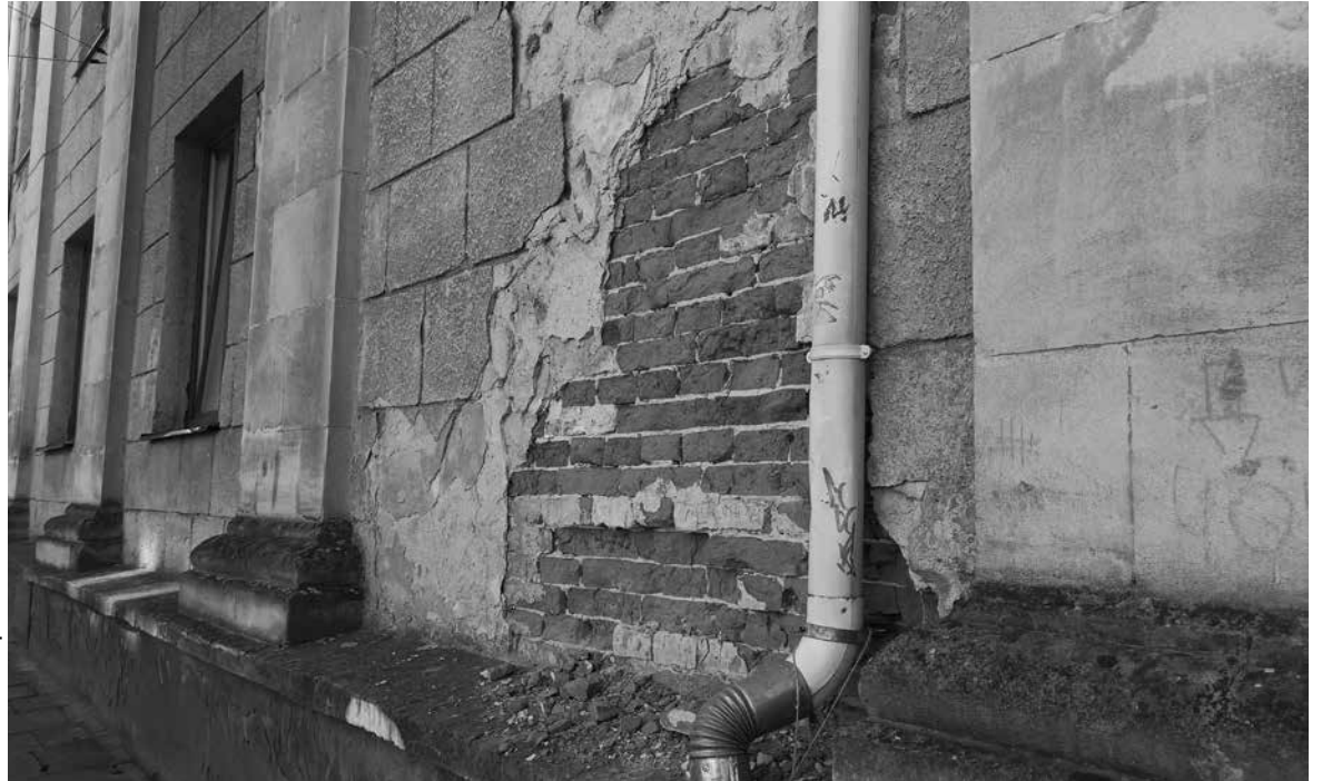
У серпні, як ми помітили, через облуплене покриття фасаду було видно цегляну кладку
