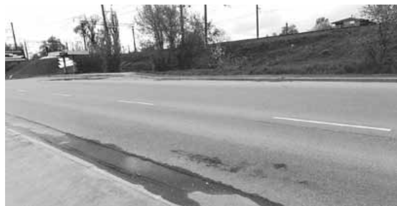
Такий вигляд має частина асфальту, де робили ремонт три роки тому. Цю ділянку лагодили не в рамках проєкту «Велике будівництво», а виключно за кошти місцевого бюджету
