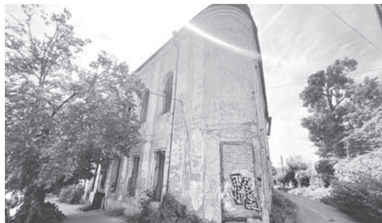
Такий вигляд має будівля колишньої «Вінницяфармації». Будинок перебуває в аварійному стані, але попри небезпеку всередині постійно збираються підлітки та безхатьки
