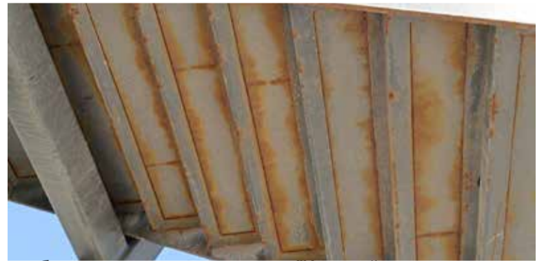
Особливо сильно метал конструкції іржавий на сходах. Це легко помітити, якщо стати під ними
