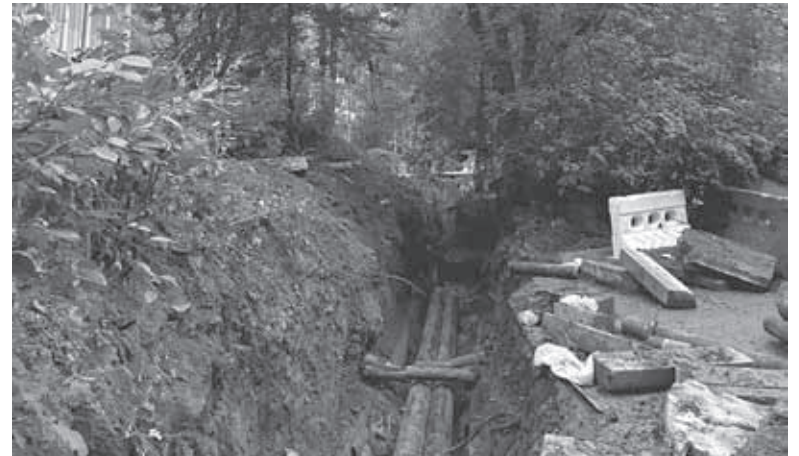
Наслідки ремонту інженерних комунікацій. Корені дерева сильно пошкоджені: з часом воно або засохне, або впаде
