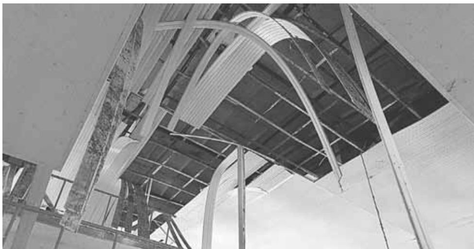
Вагонка у багатьох місцях повідлітала зі стелі. Видно залізну конструкцію покрівлі
