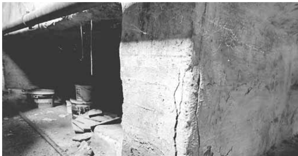
Опора чаші почала тріскатися. Пошкодження є і на поперечних балках
