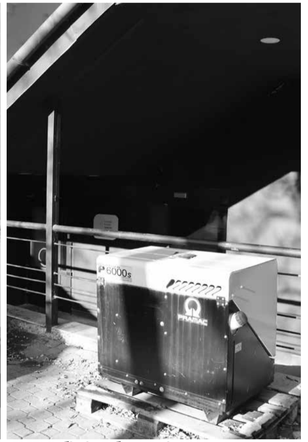
Пункти обігріву обладнані генераторами
