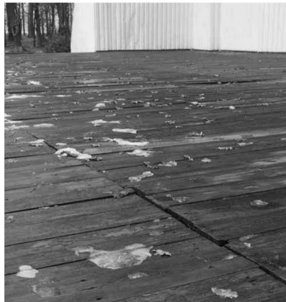
Дошки пошкоджені та деформовані
