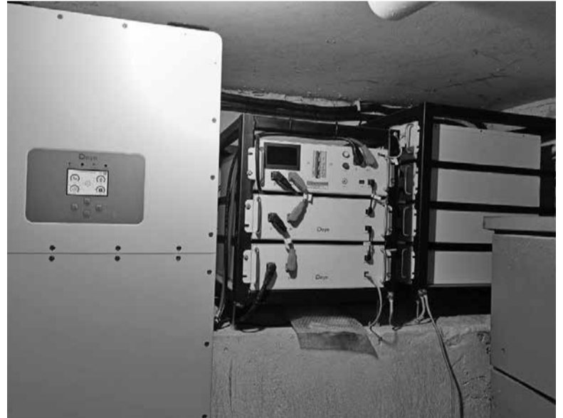
Гібридний інвертор дозволяє заживляти у будинку ліфт, освітлення, камери відеоспостереження, домофони, поштомат
