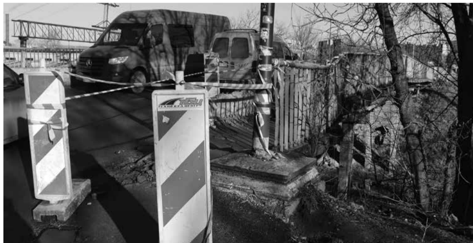
На пішохідному проході пошкоджене покриття. Прохід пішоходів перекритий стовпцями та сигнальною стрічкою
