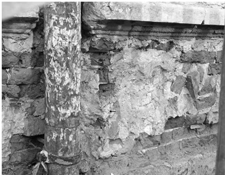
Приміщення колись залізничної лікарні зараз виглядає занедбаним. Тут руйнується фасад, балкони, вікна
