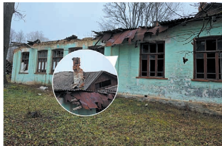
Підряднику доручили перебудувати шкільний корпус №2. Зі світлин видно, що зараз він в аварійному стані
