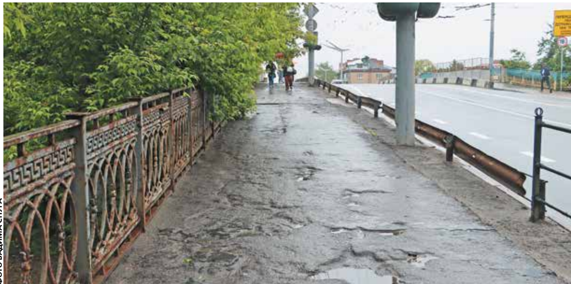
Тротуари в ямах та потребують ремонту
