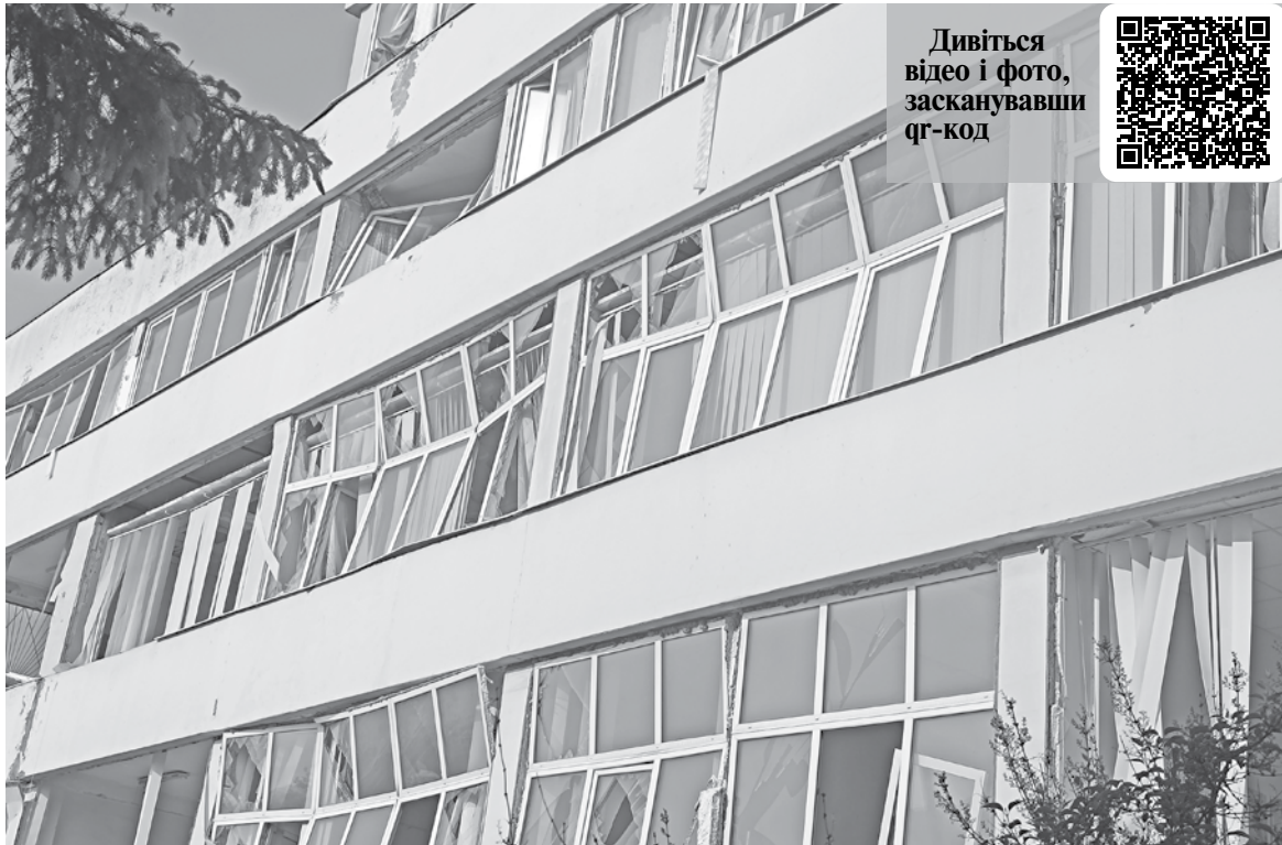
Один із корпусів технічного університету зазнав пошкоджень від атаки. Тут, зокрема, повилітали вікна, є пошкодження всередині
