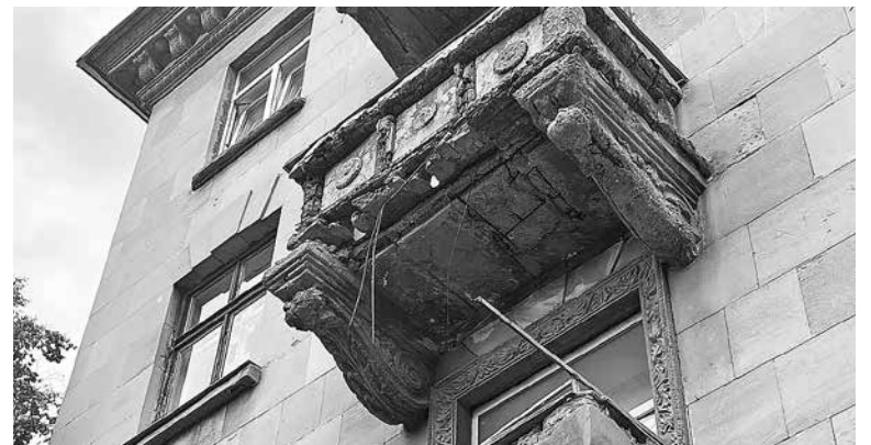
На деяких балконах вже утворилися дірки, а металеві конструкції звисають
