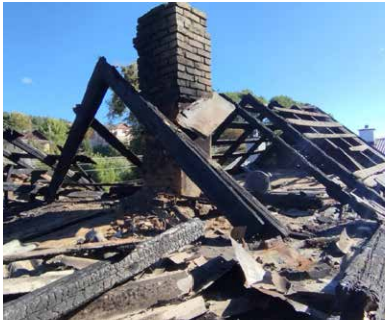
Гасіння було ускладнене тим, що будівля була повністю дерев'яною, що сприяло швидкому поширенню вогню
