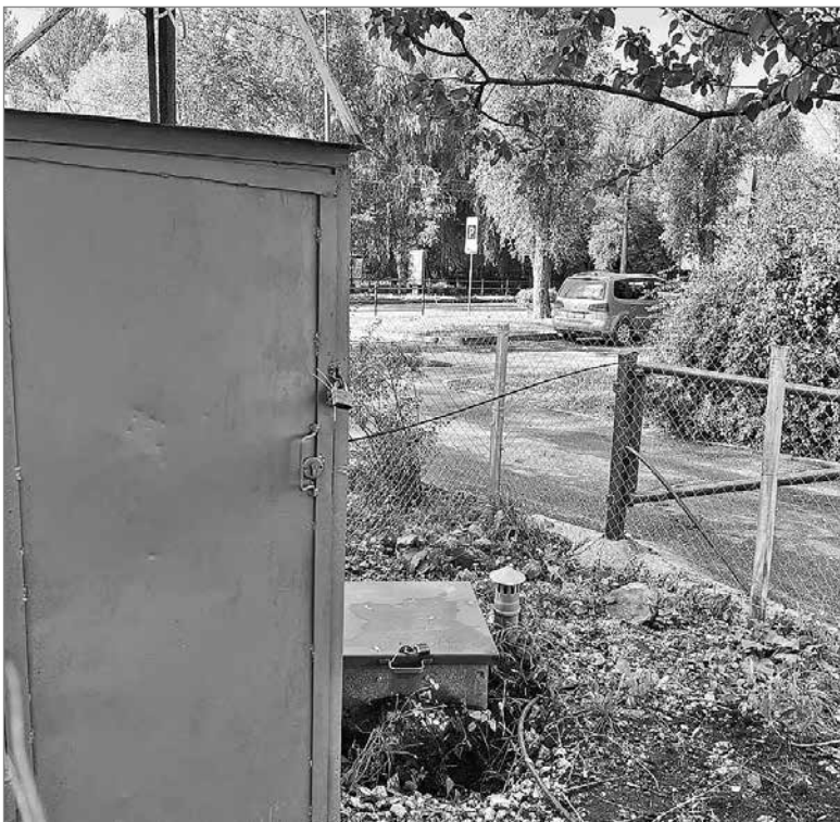
Спеціальна мінінасосна станція призначена для того, щоб укриття не затоплювало ґрунтовими водами
