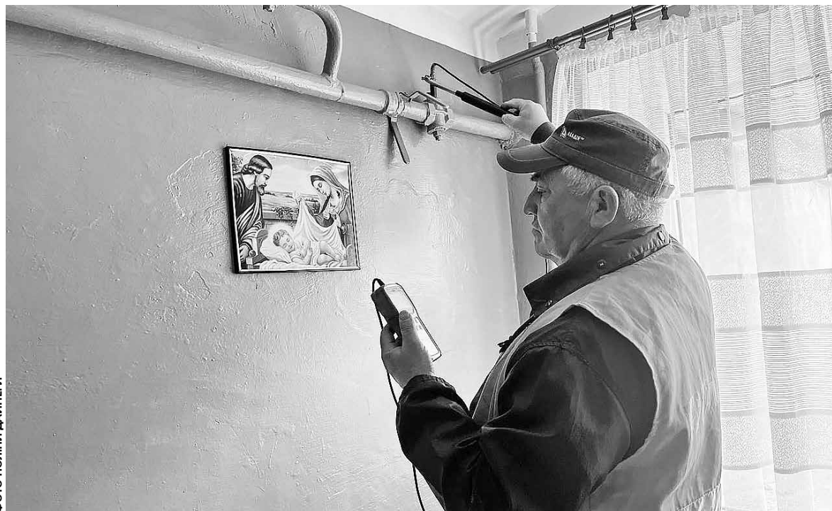
Газові крани та труби потрібно регулярно перевіряти — пересихання чи тріщини можуть спричинити витік
